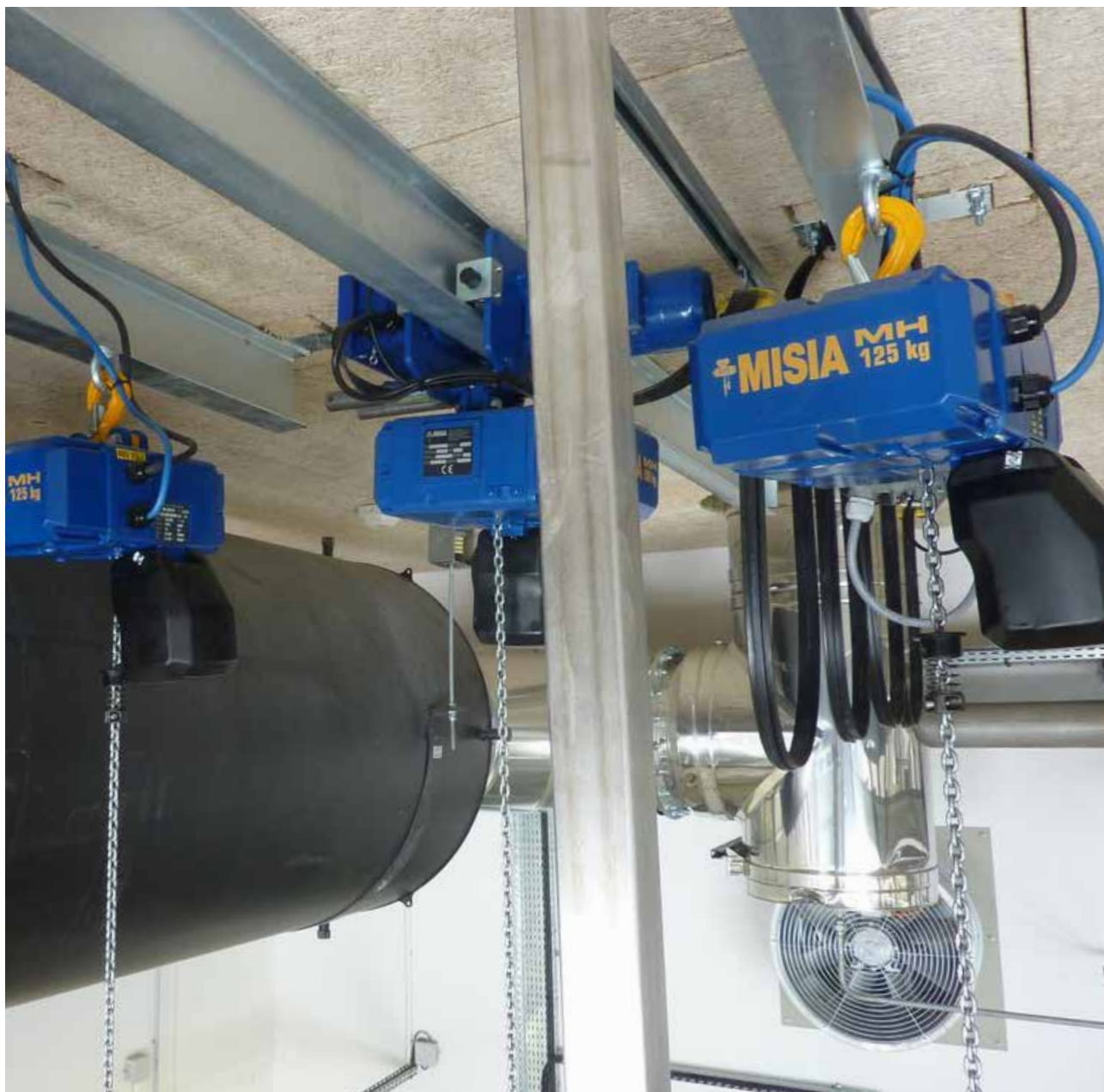
Impianto di verniciatura - Painting plant
